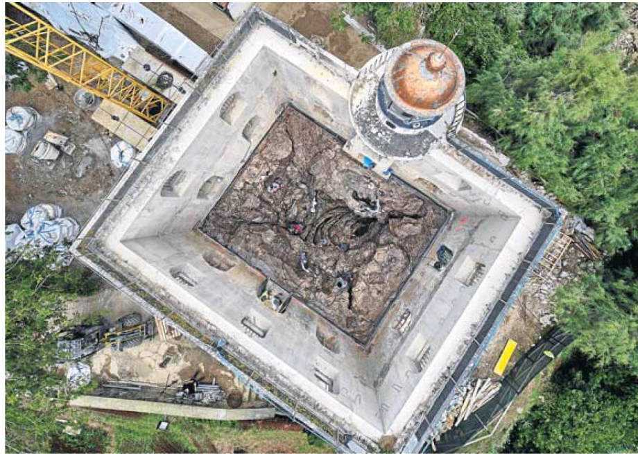
Imagen de la obra, tomada a veinte metros de altura. J. L. LÓPEZ DE ZUBIRIA
